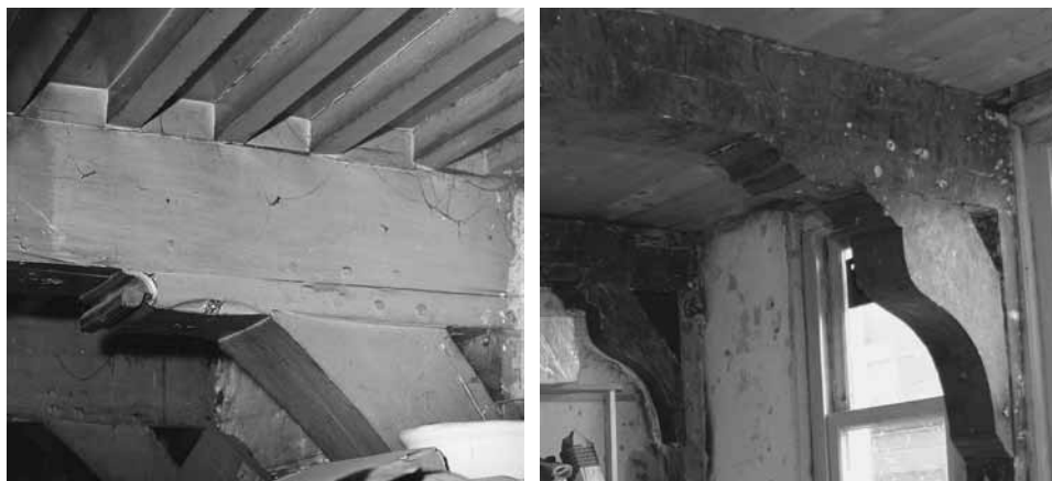
Afbeelding 8: Amsterdam, peerkraalsleutelstuk in Warmoesstraat 38 en zwanenhalskorbeel in Spuistraat 51 (foto BMA/auteur).
