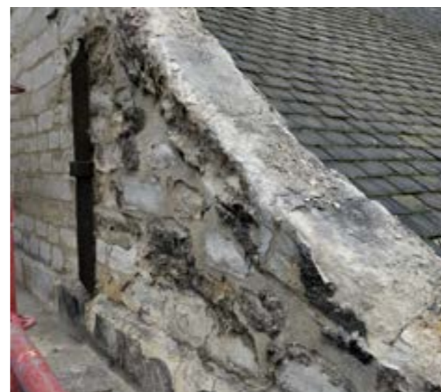
Gipskorsten, een typische vorm van degradatie bij kalksteen
