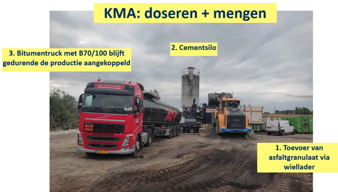
Figuur 11: opstelling productie-unit BSM – proefvak 1
