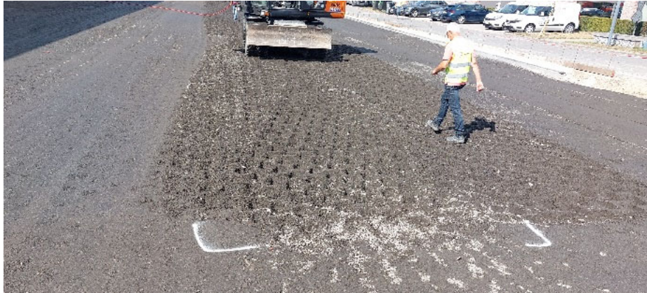
Figuur 50: markering problematische zone proefvak 2
